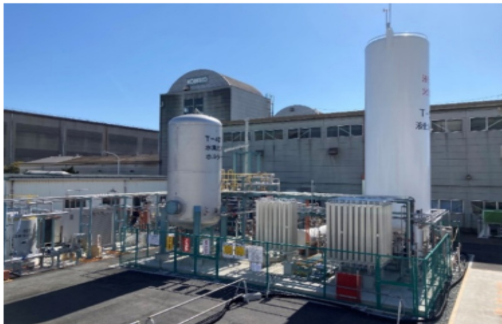
実証設備外観
