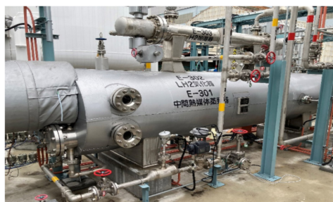
中間媒体式液体水素気化器外観
